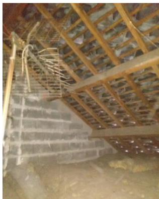
FIGURE 23 : COMBLES DU 5 IMPASSE DE PERREYEUX AVEC DE NOMBREUX ACCES AU NIVEAU DES ARDOISES
