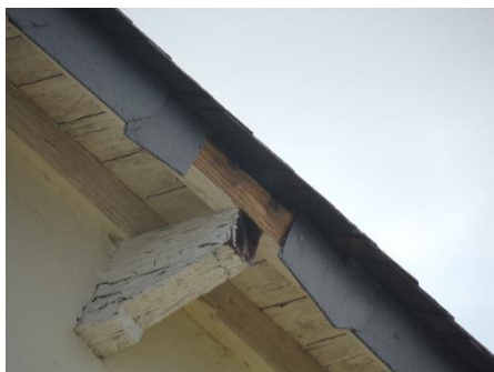
FIGURE 22 : ARDOISE MANQUANTE DONNANT ACCÈS À UN ESPACE SOUS-TOITURE
