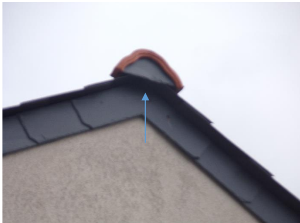
FIGURE 21 : ACCÈS AU NIVEAU DE LA FAÏTIÈRE DU PIGNON SUD DU 15 RUE DE LA FOUCAUDIÈRE
